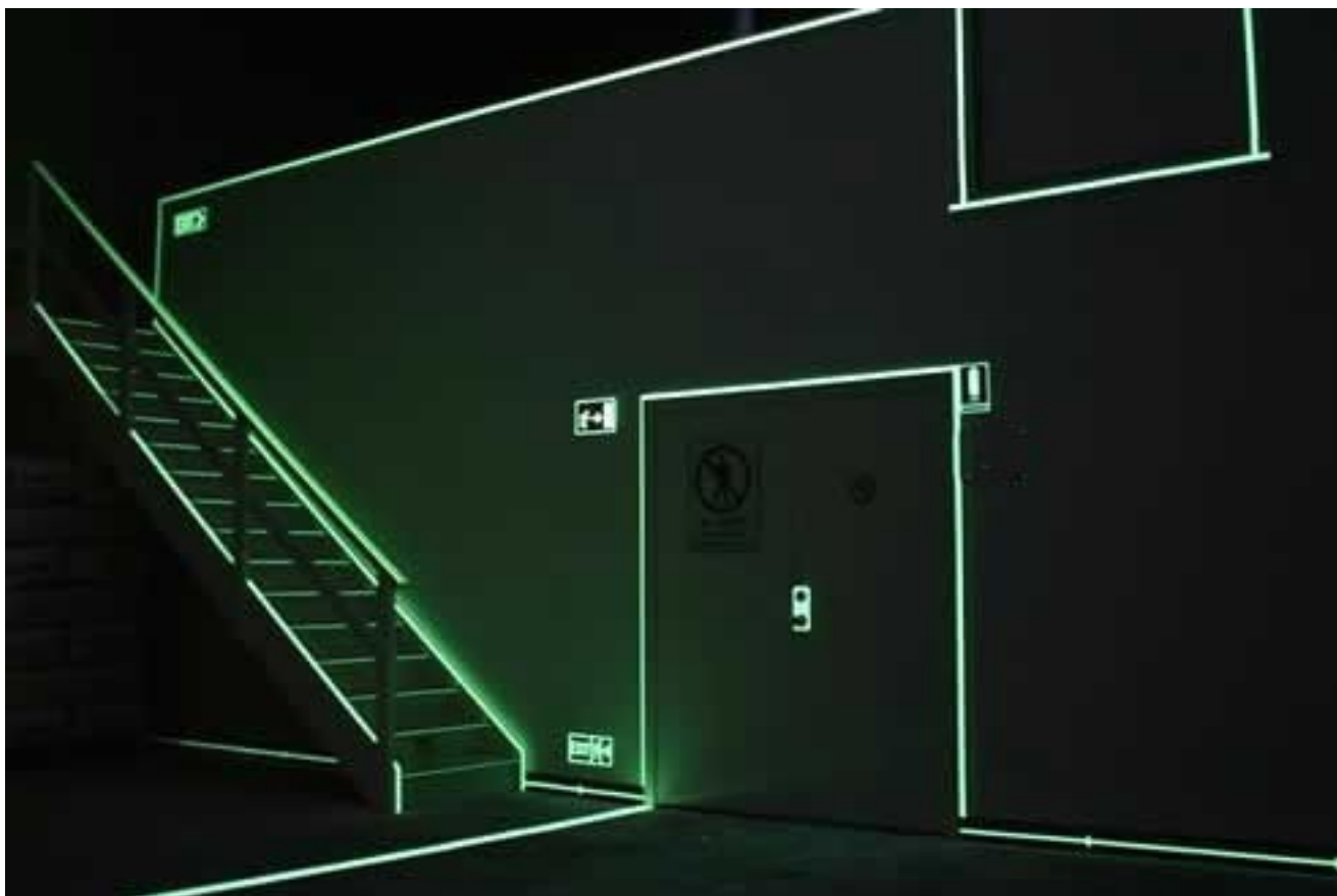
Vista de un sistema de guía fotoluminiscente en condiciones de oscuridad
